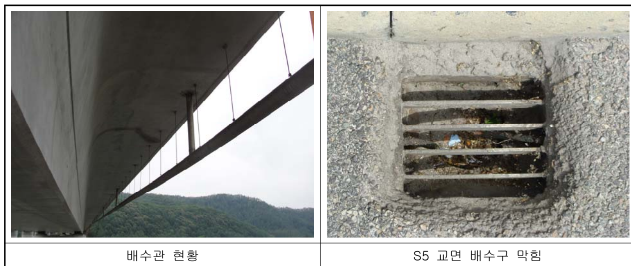
【사진 3.10】 배수시설 손상 현황
