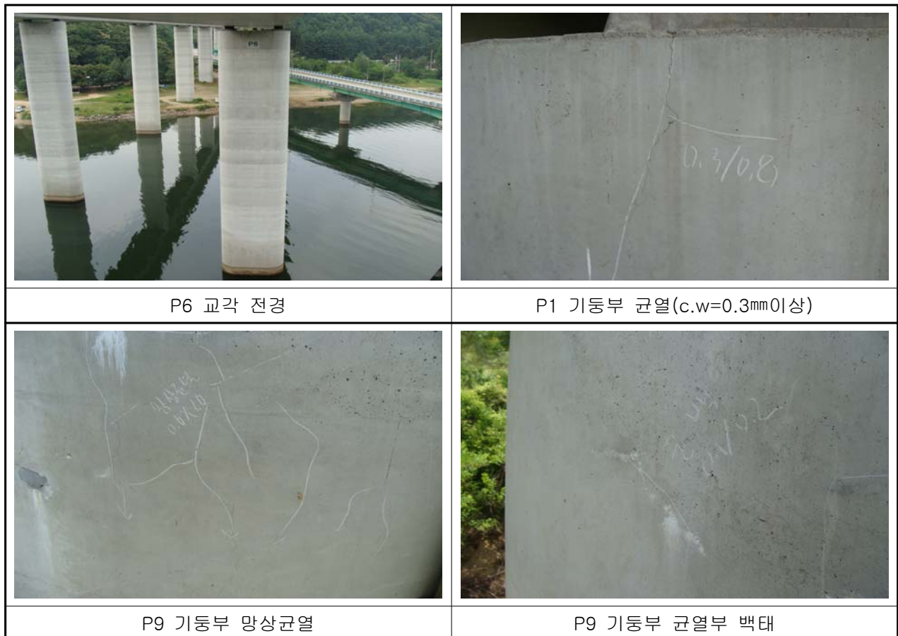
【사진 3.4】 교각 손상현황
